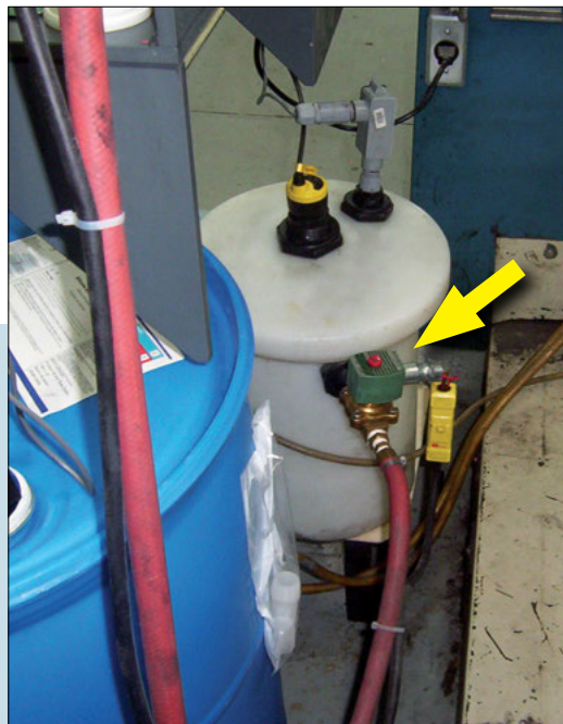
Figure 98 - Vanne électromagnétique bloquée Source : CMMTQ.
