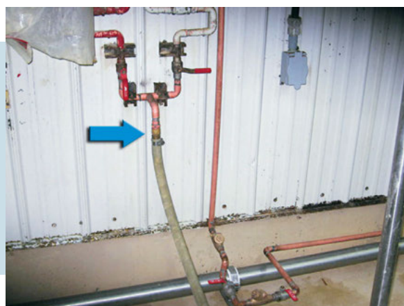
Figure 92 - Robinet de lavage non isolé Source : CMMTQ.
