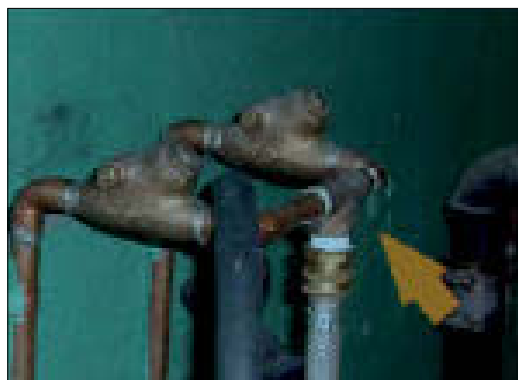
Figure 99 - Absence de casse-vidé Source : CMMTQ.
